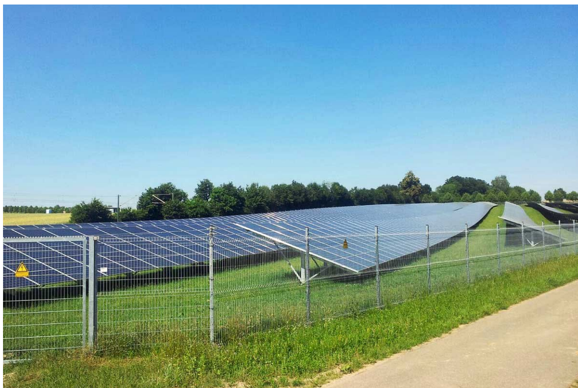
Figura 2: Recinzione parco fotovoltaico [fonte MKG Göbel]
